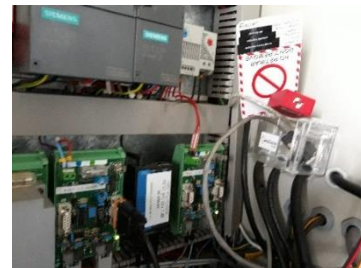
Detalle de la tarjeta de comunicaciones, desconectando el display por un lado y el cable ethernet de comunicaciones remotas. Consignación de ambos conectores.
